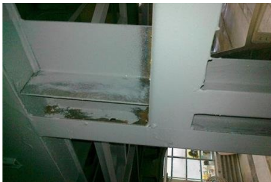
Rysunek 8. Nieprawidłowe wykonanie zabezpieczenia wewnątrz konstrukcji.
