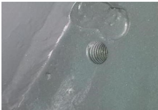
Rysunek 12. Brak zabezpieczenia gwintów zewnętrznych i wewnętrznych przed malowaniem.
